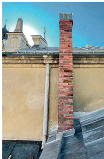
Lwów, komin na dachu katedry ormiańskiej przed pracami zabezpieczającymi i po ich zakończeniu
